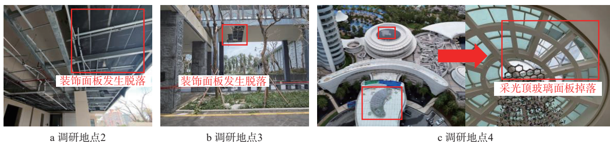
图6 酒店装饰面板及采光顶玻璃脱落
