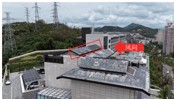
图3 调研点1处建筑屋面光伏结构破坏
